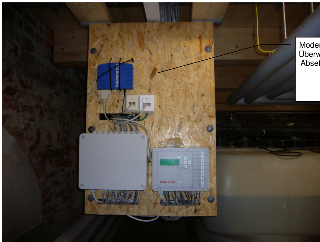
Beispielanlage im Papst Geburtshaus
